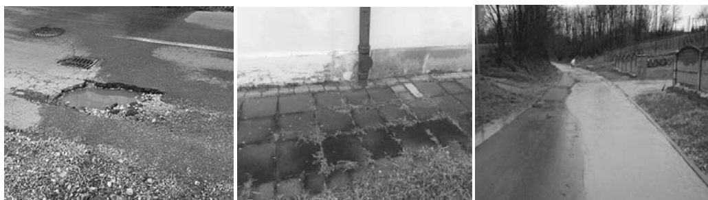
Slika 10. Primjer neodržavanja cesta, pješačkih staza uz objekt i pripadajuće odvodnje, [6],[9].
