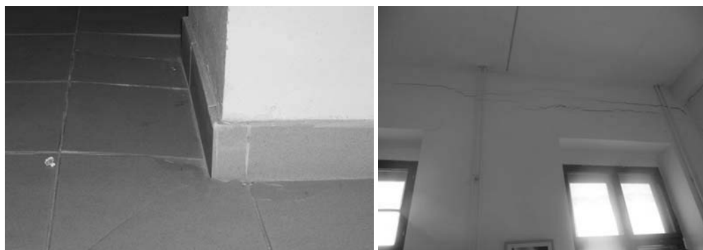
Slika 7. Slijeganje temelja (lijevo) i pukotine na zidovima na vukovarskoj gimnaziji.
