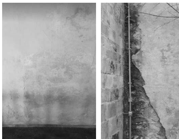
Slika 6. a) Promjena boje na zidu, b) Nedostatak maltera na vanjskoj fasadi
