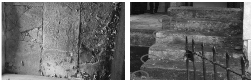
Slika 5 .Površinsko oštećenje kamenih i drvenih podova
