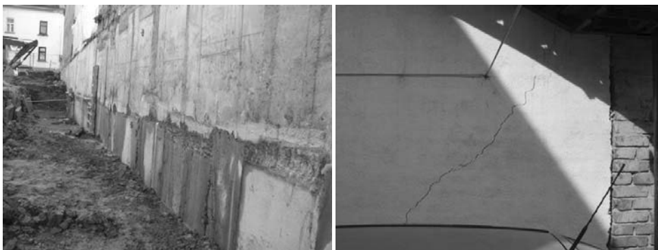
Slika 9. Podbetoniranja temelja kod osiguranja građevne jame (lijevo) i nastanak pukotina na susjednom objektu (desno), primjer građevne jame u Slavonskom Brodu.
